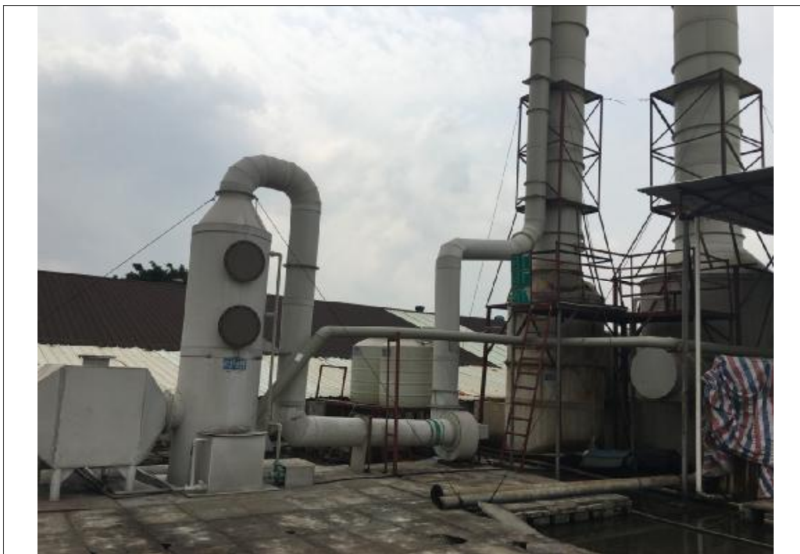
有机废气治理系统
