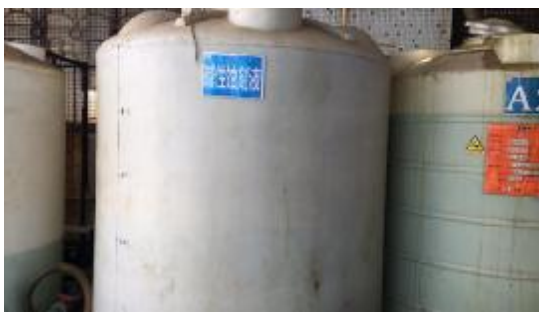
氨水储罐标识
