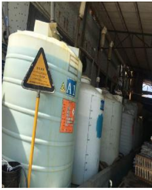
废液储罐（设置围堰）
